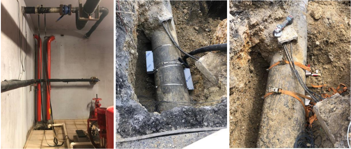
Şekil 3: Su dağıtım şebekesinin giriş borusu ve ultrasonik debimetreyle debi ölçümü
